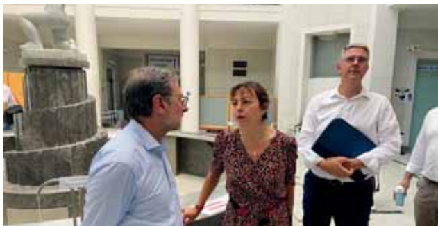
Échange durant la visite du chantier des Thermes de Luchon entre M. le Maire et Mme Carole Delga, Présidente de la Région Occitanie.
