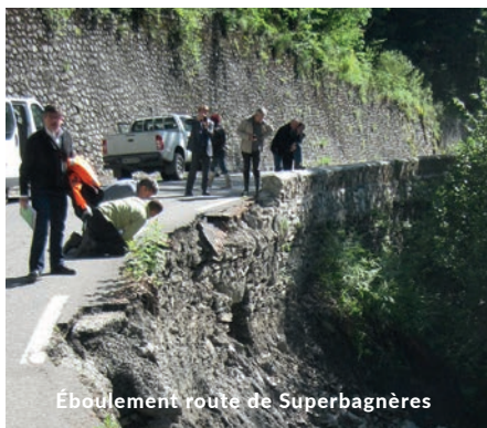
Éboulement route de Superbagnères
